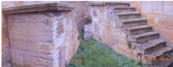
Slike 32, 33. Stubište u zaseoku Ramljaci-Čitluk, debljine originalnog sloja iz kamenoloma od 6 cm
