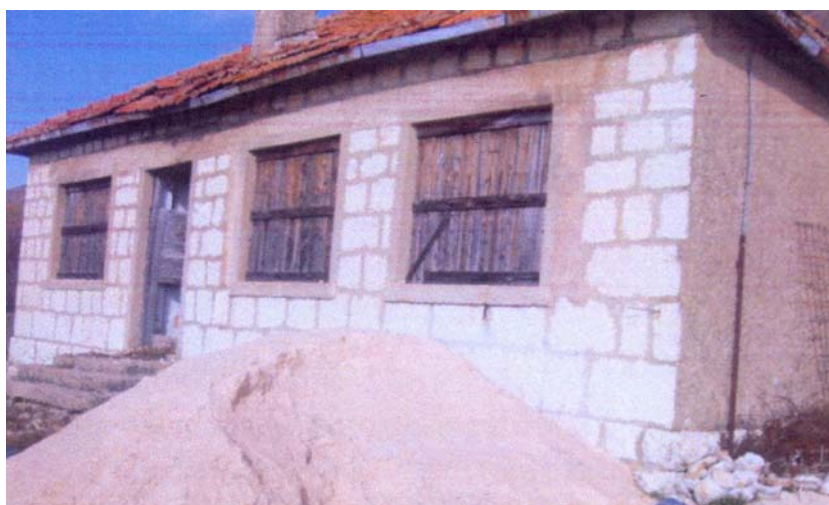
Slika 14. Osnovna škola Zavelim nije u funkciji, građena iza II. svjetskog rata, od eocenskog autohtonog vapnenca, lijepo obrađenog, špicanog; Kamen nema promjena od vanjskih utjecaja
