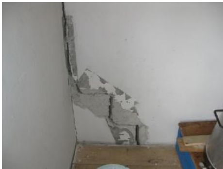
Slika 5. Pukotina na nosivom, vanjskom zidu
