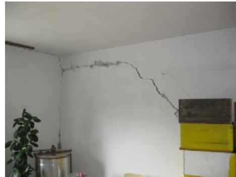
Slika 4. Pukotina na nosivom, vanjskom zidu
