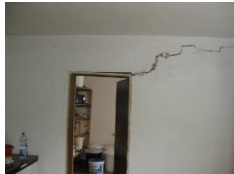
Slika 6. Pukotina na nosivom, unutrašnjem zidu
